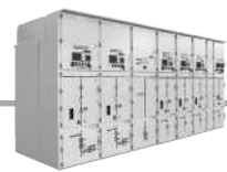
Metal Clad Switchgear
